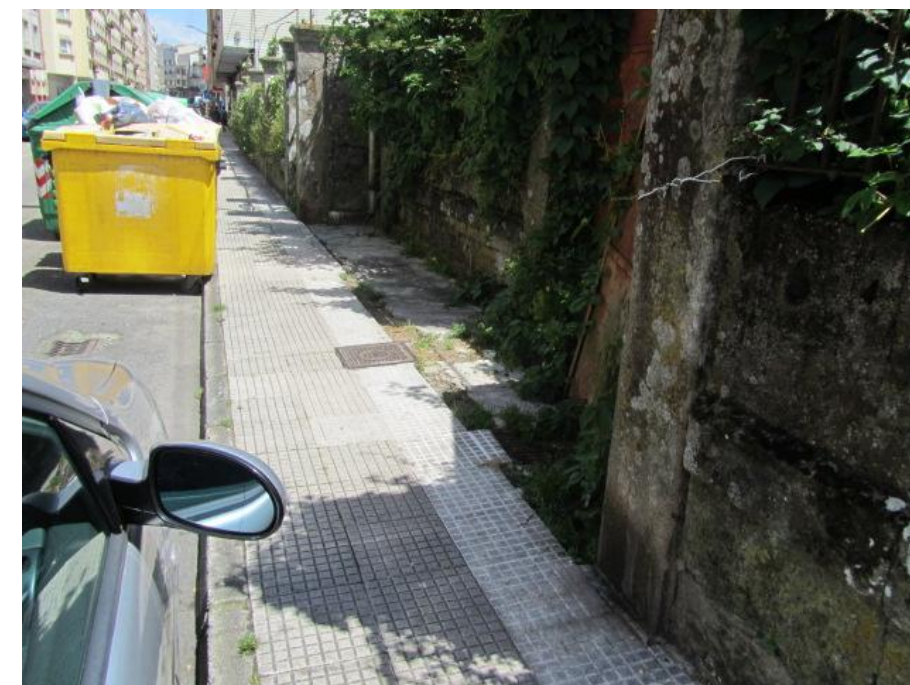
Foto 29, muro de cierre de las fincas nº94 y nº96 en estado de abandono
