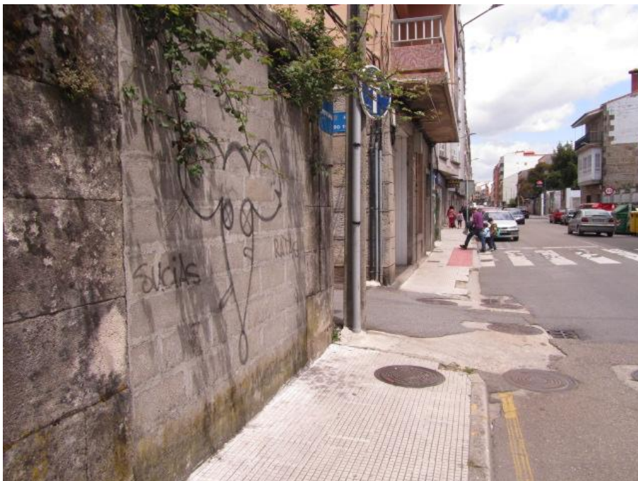
Foto 40, fachada edificio nº 85, ruina de próxima demolición.
